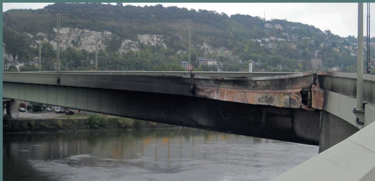
Le pont Mathilde après l'incendie (© Cerema)
